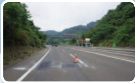
工事前のわだちがある道路
